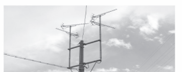
TV共聴設備工事 及びメンテナンス
